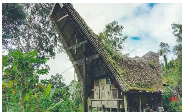
Gambar 2. Tongkonan To Masserek Tallung Leso Tau sebelum direnovasi
